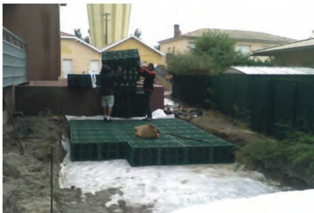
Stockage et infiltration des eaux de toitures d'une résidence, sous espace vert.
