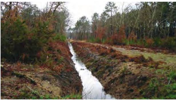
COMMUNE DE LANTON Découplage hydraulique - Maître d'ouvrage : SIBA.
